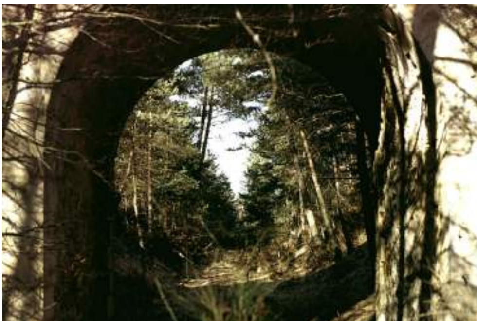
1982. Entre La Trappe et Dionay, passage de la voie sous un pont aujourd'hui comblé.
